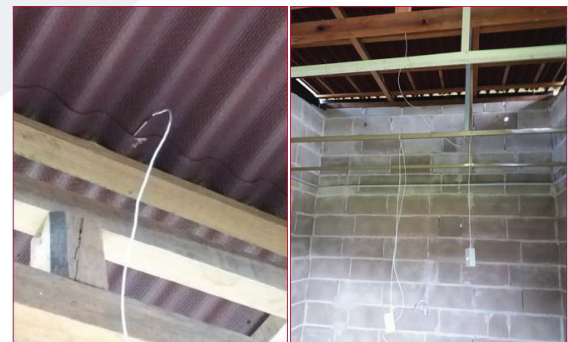
Cảm biến nhiệt được lắp đặt trong công trình có mái Onduline.
